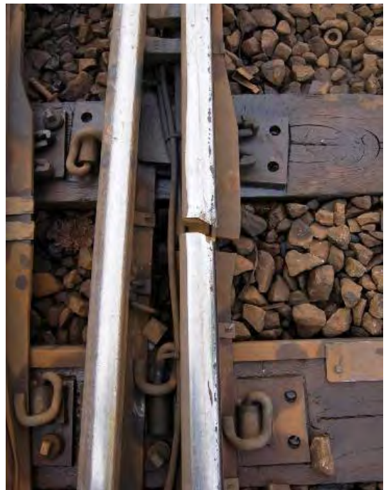
Figur 6: Nærbilde av bruddet etter at toget er fjernet.
