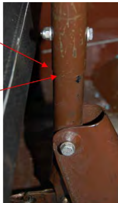
Figur 4: Stikke feil montert.
