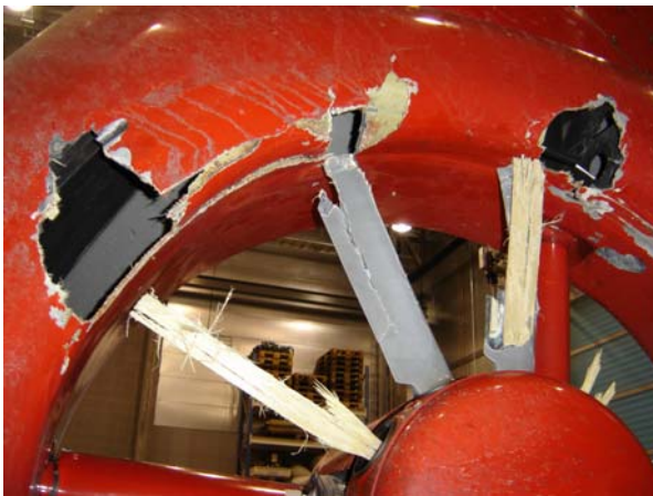
Figur 8: Skade på blader og tunnelen.
