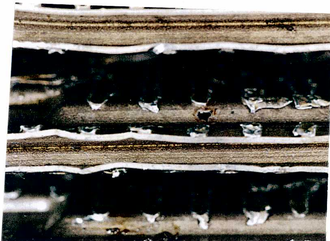
Fig 2. Tydelig hull på det oljeførende røret, kjøleribbene er fjernet.
