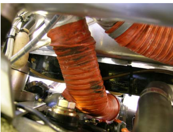
Fig. 2 Luftslangen slik den ble funnet. (avbildet uten slangeklemmer). Bilde viser at området er trangt og at slangen må bøyes.
