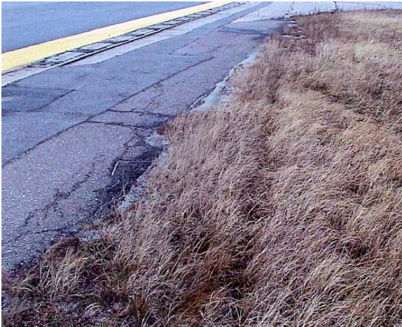
Fig. 3: Sett nordover (mot fartsretning). Spør etter venstre hovedhjul der LN-SPO forlot asfaltdekket rett sør for taksebane B.
