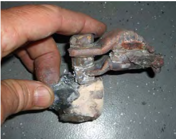
Figur 3: Viser koblingspunkt i koblingsboks.
