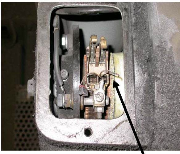
Bilde 4 Bildet viser de defekte børstene til viftemotoren.
