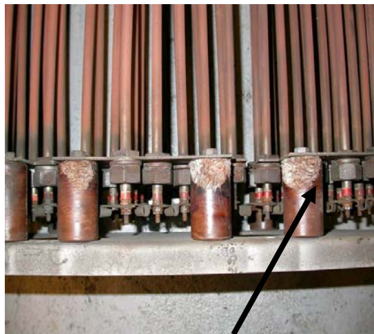
Bilde 5 Isoleringsklosser i tilleggsvarmeenheten
