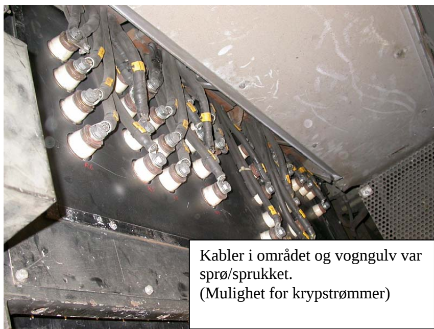
Bilde 6 Morken isolasjon på ledninger i området omkring kjøre-bremsestand.
