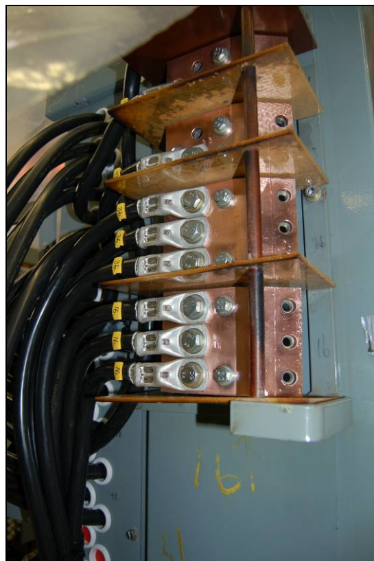
Figur 9 Nye høyspentkabler koblet til strømskinne.
