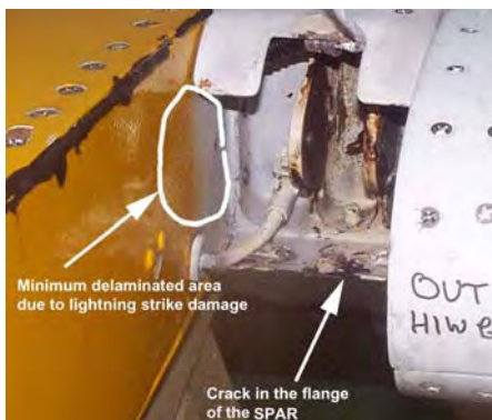
Fig. 7a Skade på hovedbjelkens flens ved ytre hengslepunkt
