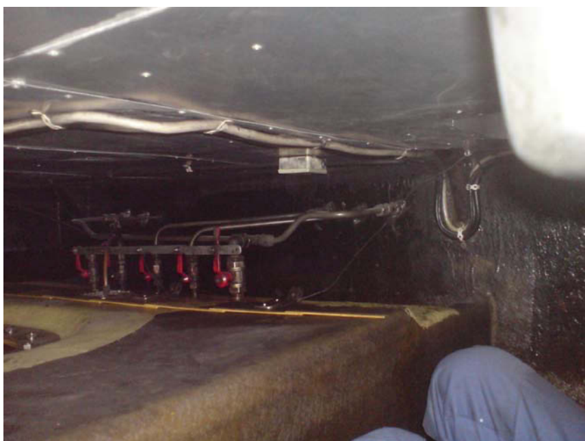
Figur 6: Bildet er tatt fra søsterskipet og viser alle gjennomføringene fra maskinrommet, og ventilene for nødstenging av brennoljesystemet. Fra høyre:
