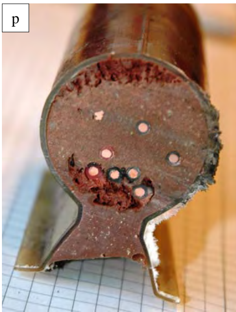
Figur 5a-p Bilde av snittflater etter seksjonering av kabelmuffe som vist i Figur 4.
