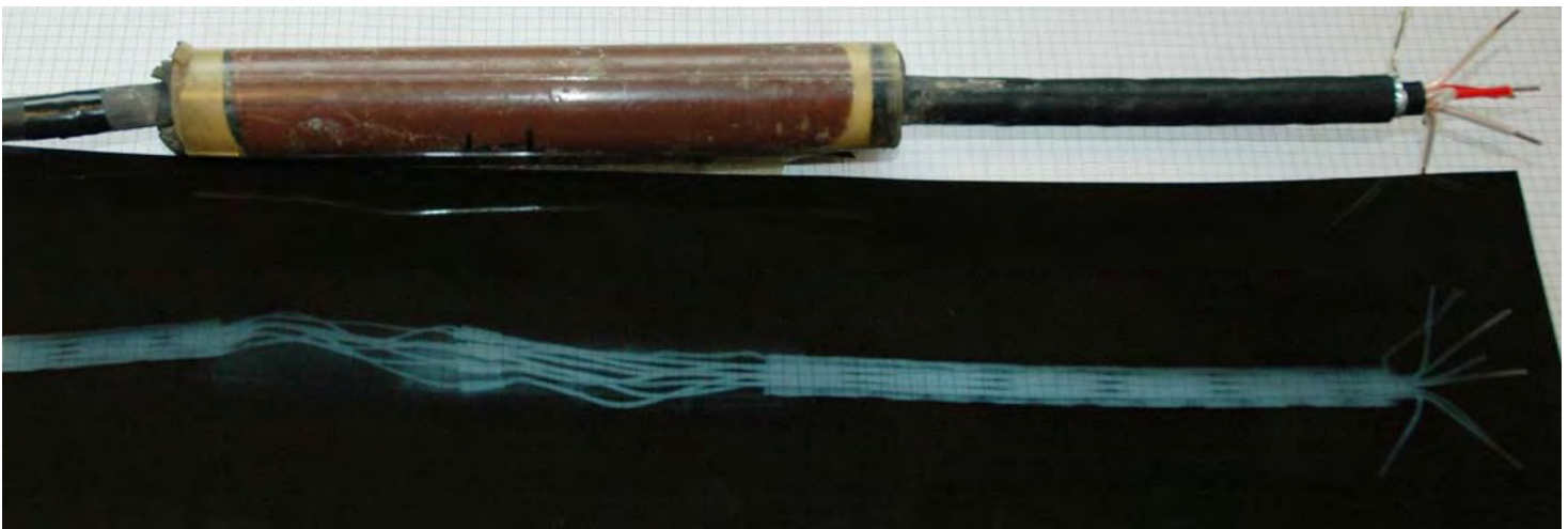
Figur 2 Bilde av kabelmuffe med røntgenbilde som viser ledere med skjøter i muffen.
