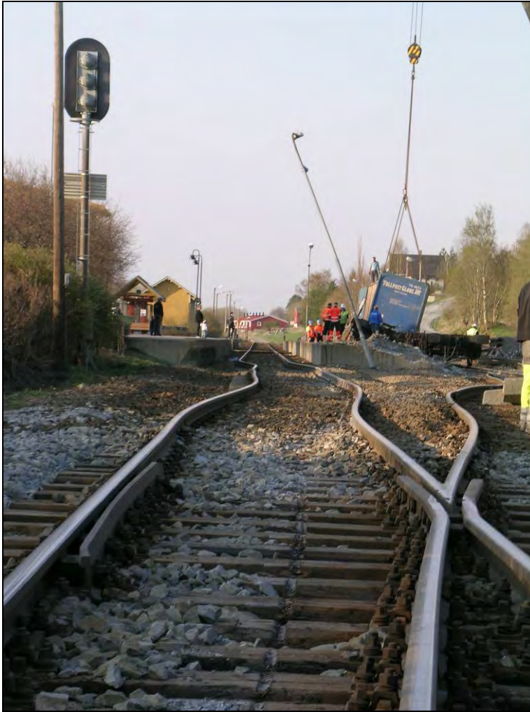
Figur 7: Viser at det oppstod omfattende skader og forskyvning av sporet. Vognen som stoppet i spor 1 var fjernet da bildet ble tatt under oppryddingsarbeidet.
