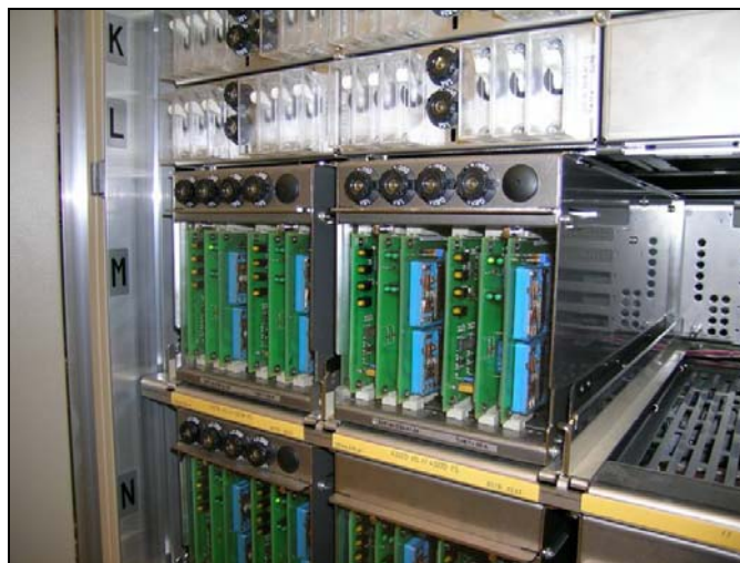
Figur 10: Bilde av objektcontroller til signal N 4323
