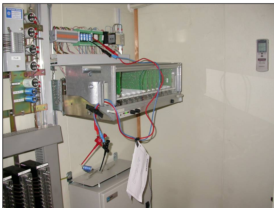
Figur 9: Grensesnitt system EF 180 på Slependen blokkpost. Dette overfører signalinformasjonen mellom reléanlegget på blokkposten og datastillverket på Sandvika stasjon via en telekommunikasjonskabel.
