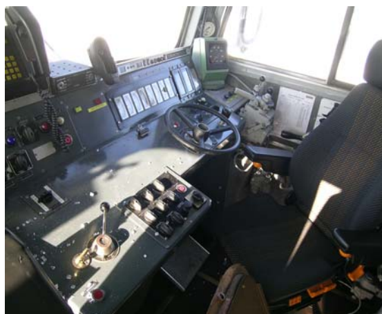
Figur 2 viser glasskår i førerrommet
