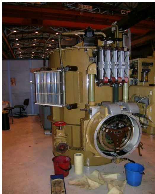
Figur 4 viser trafo og spenningsregulator. Lokket på trinnvelgerhuset er fjernet. Gnistbryterne sitter over trinnvelgerhuset.
