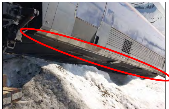
Figur 9: Det oppstod bare mindre skader langs nedre del på høyre side i de to vognene som sporet av.
