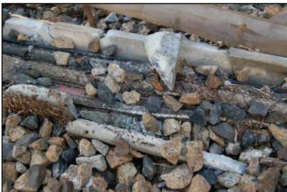
Figur 8: Kabelkanalen langs med høyre side av sporet ble ødelagt.
