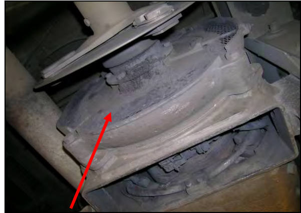
Figur 14: Bilde av motor med tett luftinntak.
