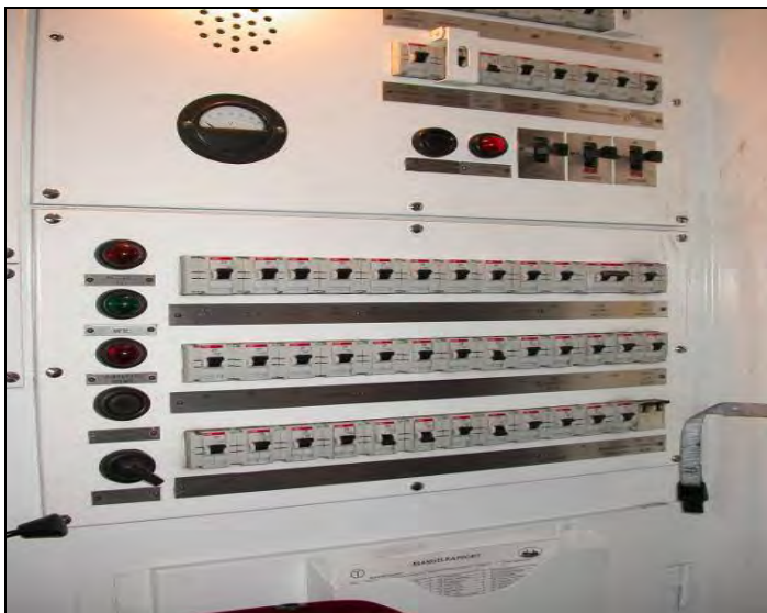
Figur 20: Bilde av sikringspanel.
